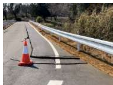
至るところ道路地割れ
