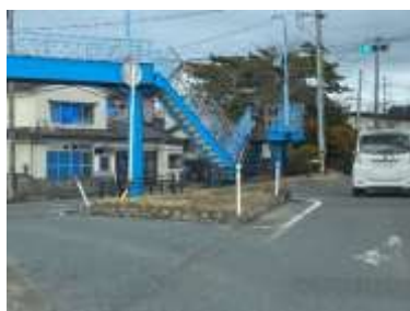
松川浦歩道橋折れる
