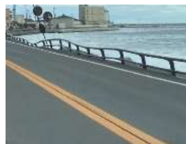
松川浦手すり歪曲
